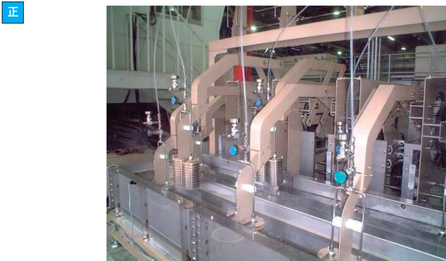
◎図4 海水交換装置の合金容器交換部
